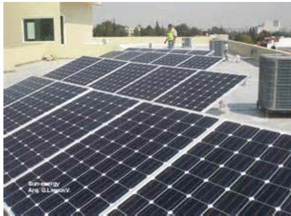
Conjunto de paneles solares
