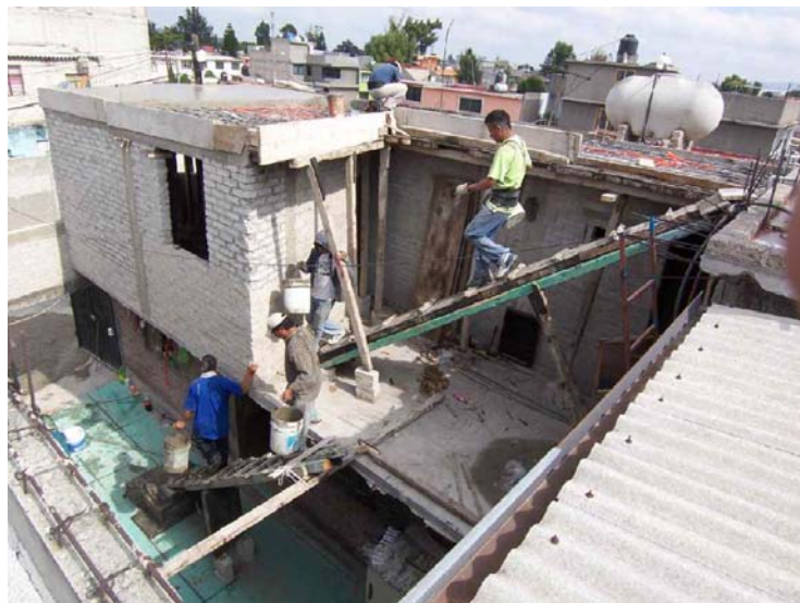
Foto 1: Andamiaje inseguro y falta de equipo de protección
