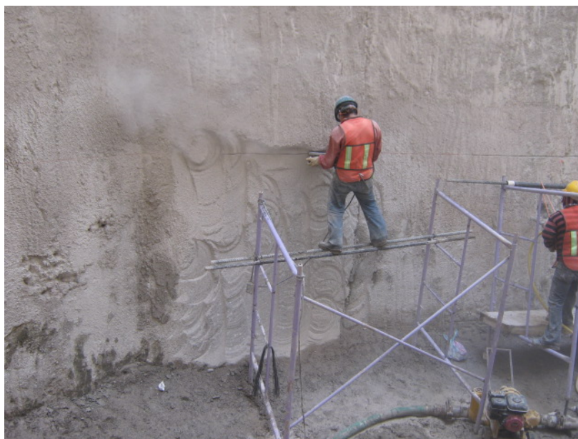
Fig. 1. Acto peligroso y condiciones de trabajo inadecuadas
