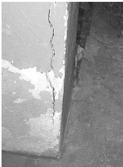
Figura 8. Agrietamiento por corrosión de armadura de acero de refuerzo en columna
