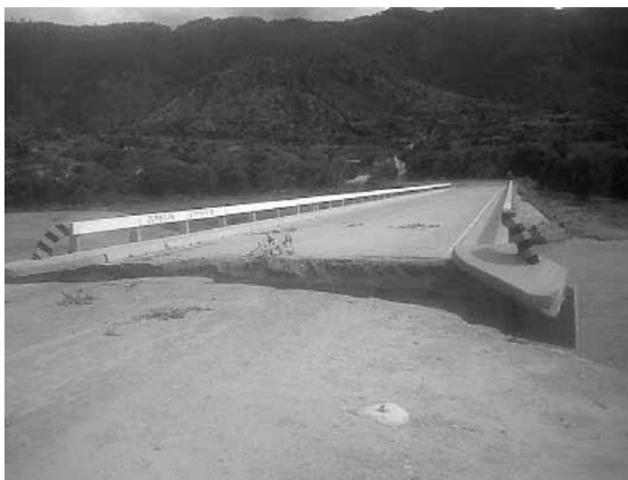
Figura 17. El puente Fray Bartolomé de las Casas II colapsó sobre el Río Negro dejando incomunicado el Departamento de Quiché
