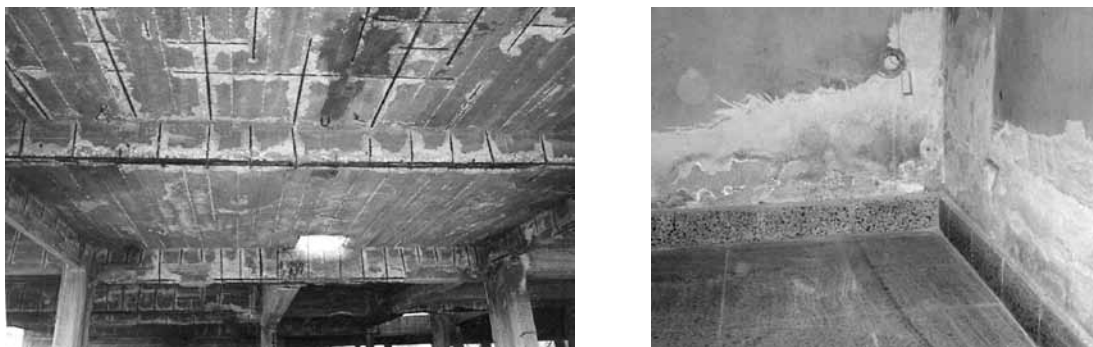
Figura. 10 y 11. Daño en cerramiento, losa y muros por filtración de humedad.
