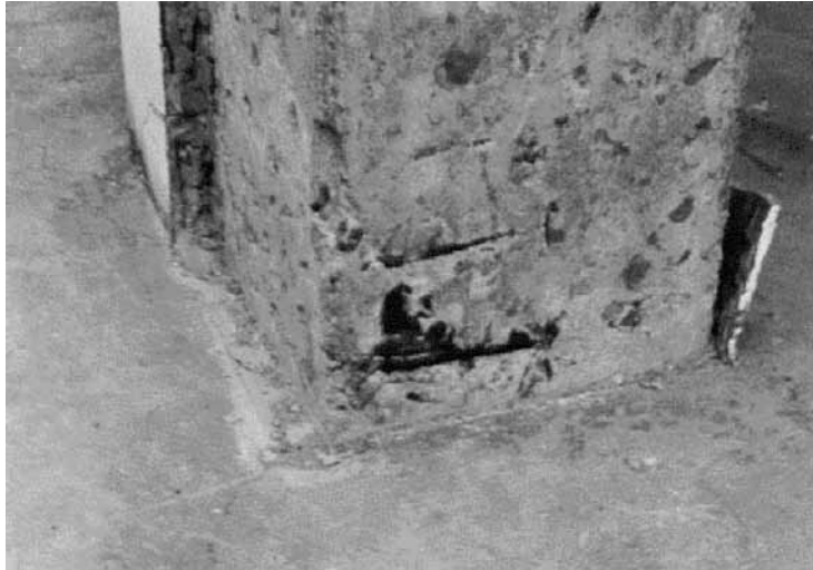
Figura 12. Corrosión en el acero de refuerzo en un edificio de la zona turística de Bahía
