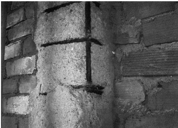
Figura 1. Oxidación y corrosión en los armados de castillo.
