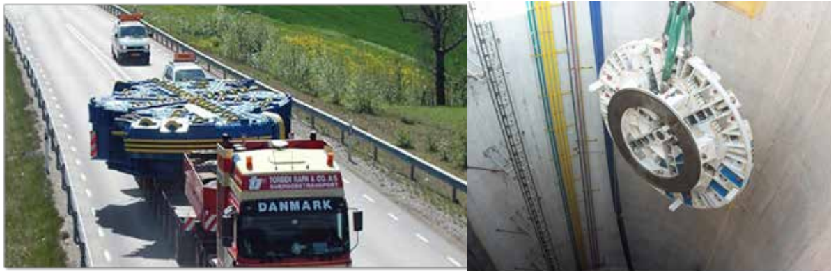
Figura 2. Traslado de rueda de corte por carretera (izq.) y su descenso a piso de lumbrera (der.)
