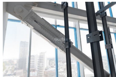
Imagen 10: Dispositivo instalado en contraviento Fuente: QUAKETEK
