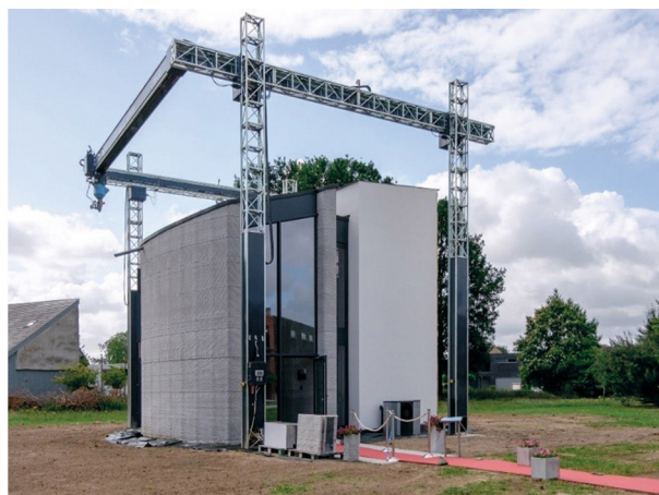
Figura 4. Casa de dos pisos impresa en Bélgica con materiales sustentables por Kamp C. Fuente: Marijk, 2020.
